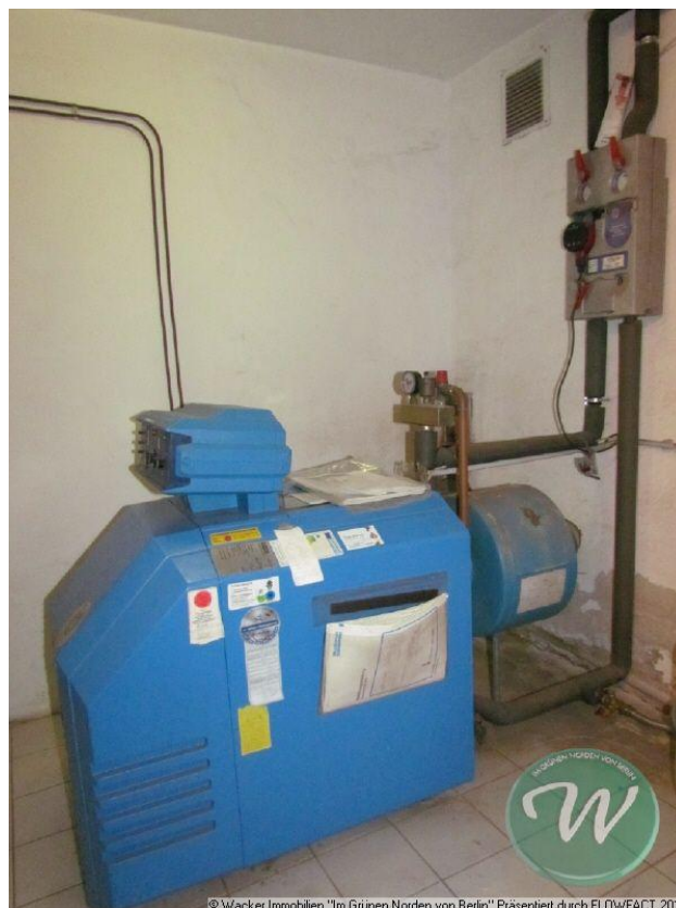
Heizanlage Buderus im Keller
